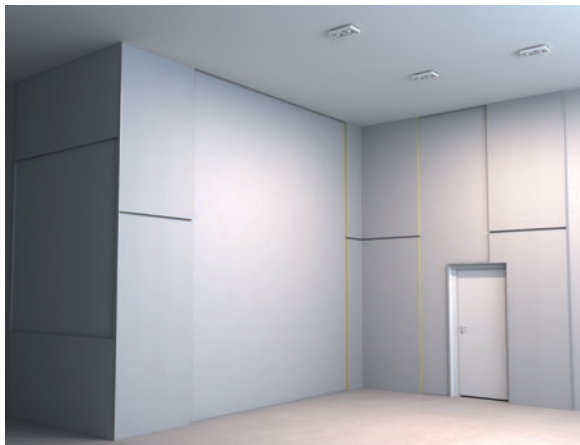
2.3 Krajní panely namontované s použitím vodorovných profilů HAT. 2.5 Zakryjte všechny spoje pomocí profilů HAT zarovnaných na šířku.
